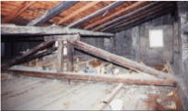
Süd- und Westwand mit doppeltem Gesperre
